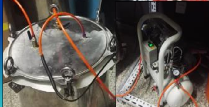
加压防水测试系统
