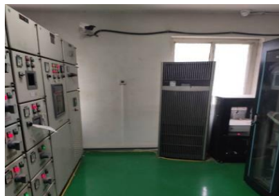
低温大厅配电室
