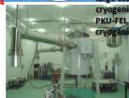
40L/h helium liquefier
