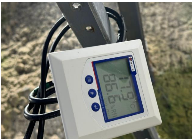
地下液闪厅更换温湿度传感器
