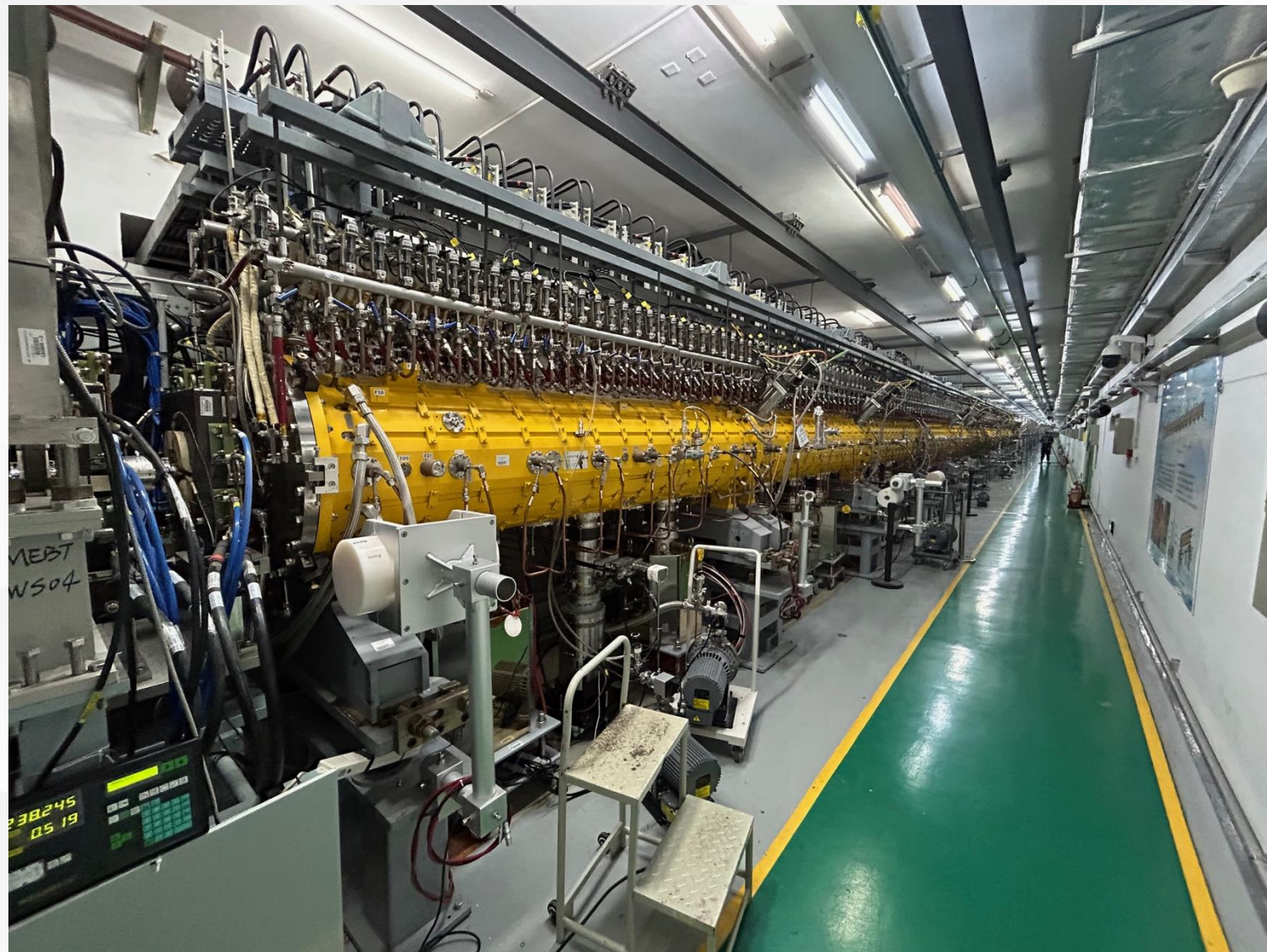
散裂直线隧道的DTL
