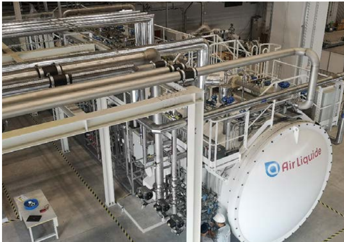
1kW@2K Cold box
