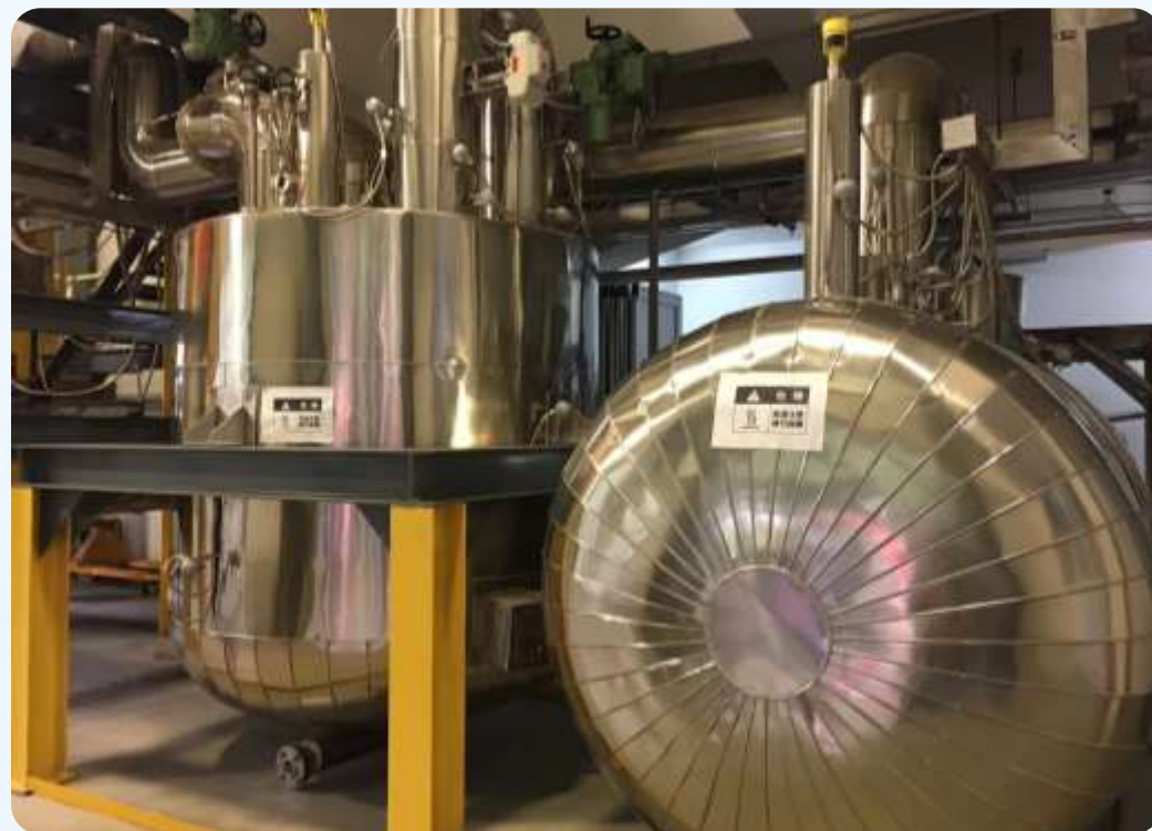
图示：2兆瓦液态燃料钍基熔盐实验堆本体
